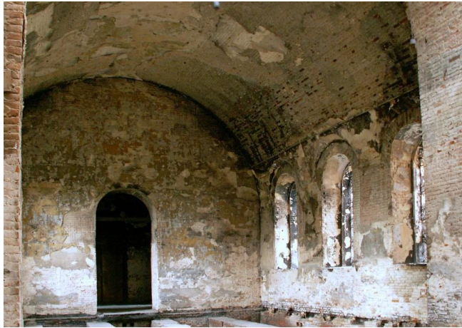
Внутреннее состояние Храма Воздвижения Креста Господня, с. Пестуново 2017 г.,
